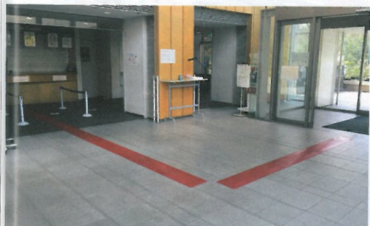
▲早稲田大学に設置した「HODOHKUN Guideway」。早稲田カラーのエンジ（えび茶色）を採用した。色は自由に選べるので空間の雰囲気を壊さない。ピクトグラム（絵文字）を描くこともできる
